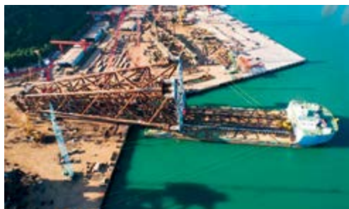
图为导管架拖拉装船中采用牵引钢缆安装新工艺作业现场
